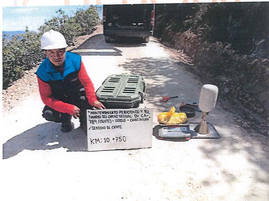
FIGURA N° 44. Ensayo de Densidad de Suelo en Campo. Progresiva 10 + 750 (Método del cono de arena).
