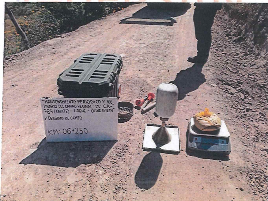
FIGURA N° 26. Ensayo de Densidad de Suelo en Campo. Progresiva 06 + 250 (Método del cono de arena).
