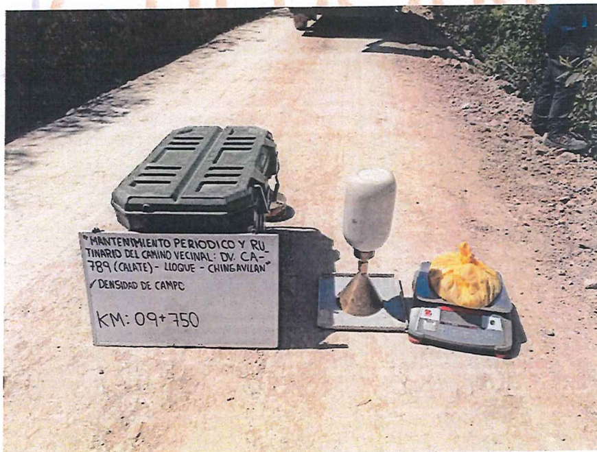
FIGURA N° 40. Ensayo de Densidad de Suelo en Campo. Progresiva 09 + 750 (Método del cono de arena)
