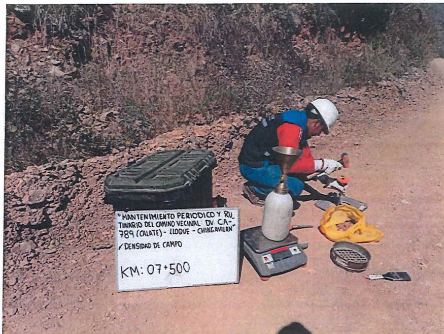
FIGURA N° 31. Ensayo de Densidad de Suelo en Campo. Progresiva 07 + 500 (Método del cono de arena).
