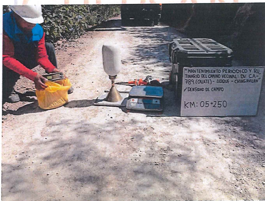
FIGURA N° 22. Ensayo de Densidad de Suelo en Campo. Progresiva 05 + 250 (Método del cono de arena).
