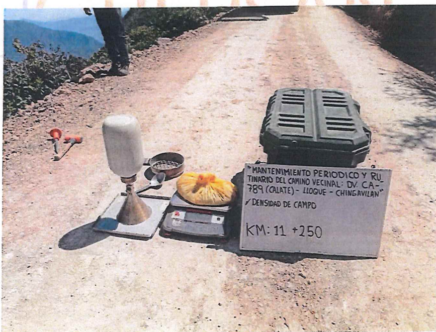
FIGURA N° 46. Ensayo de Densidad de Suelo en Campo. Progresiva 11 + 250 (Método del cono de arena).
