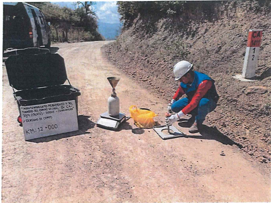
FIGURA N° 49. Ensayo de Densidad de Suelo en Campo. Progresiva 12 + 000 (Método del cono de arena).
