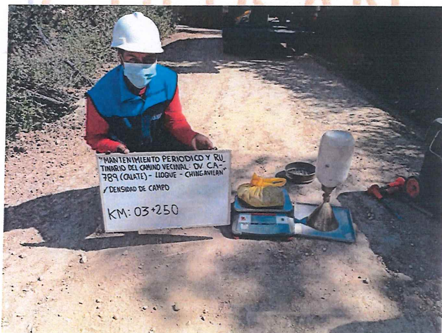
FIGURA N° 14. Ensayo de Densidad de Suelo en Campo. Progresiva 03 + 250 (Método del cono de arena).
