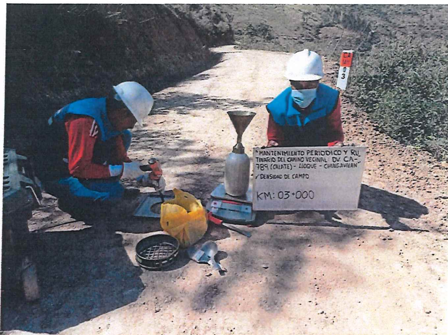
FIGURA N° 13. Ensayo de Densidad de Suelo en Campo. Progresiva 03 + 000 (Método del cono de arena).
